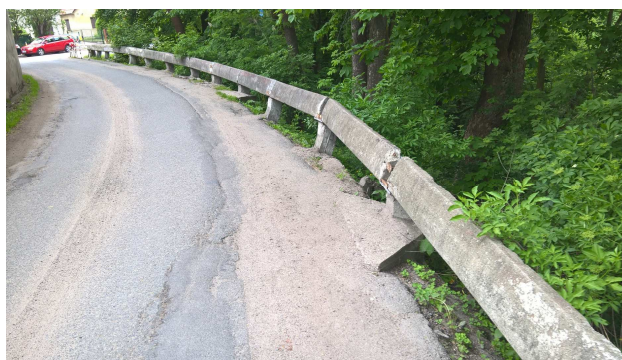
Fot. 3. Widoczne koleiny, pęknięcia i złuszczenia nawierzchni drogi, jak również odchylenie barierki ochronnej.
