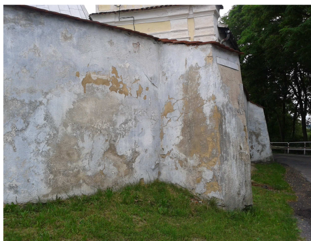
Fot. 11. Podpora muru z siatką spękań na ścianie bocznej.
