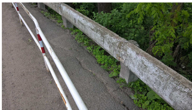
Fot. 2. Zniekształcona barierka ochronna na skutek przemieszczonych mas gruntowych. Widoczne liczne koleiny oraz odspojenia w asfalcie.
