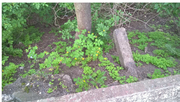
Fot. 4. Odchylenie się słupka na skutek obsunięcia mas gruntowych.
