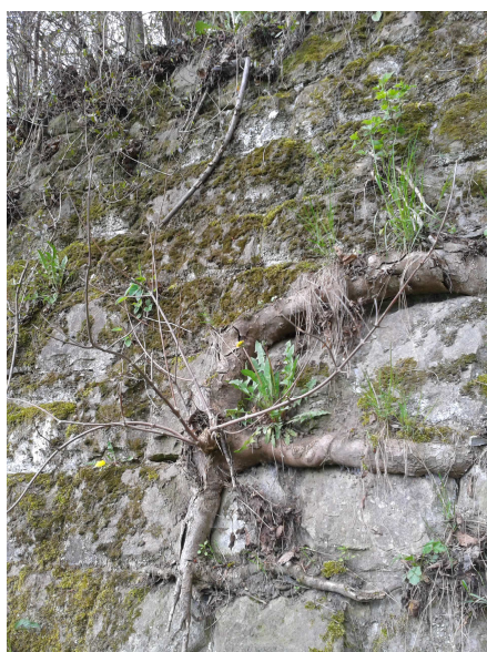
Fot. 9. Widoczne korzenie drzew penetrujące mur oporowy, również w miejscach okienek drenażowych
