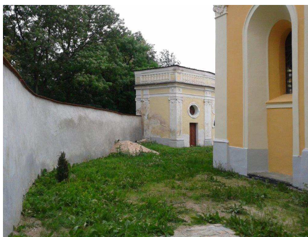
Fot. 12. Kaplica zmarłych. Pęknięcie ścinające w ścianie bocznej.
