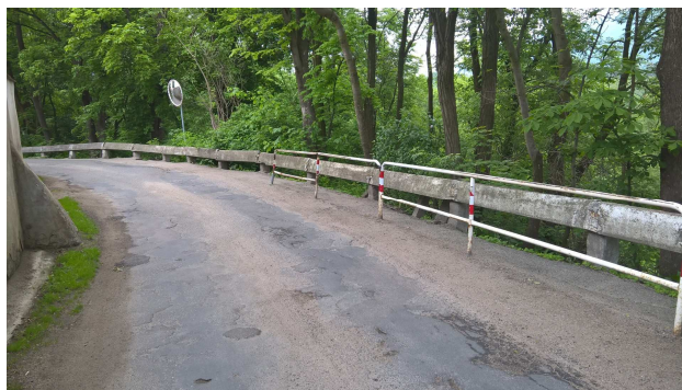
Fot. 1. Gorzanów. Widok ogólny w rejonie dysfunkcji. Uszkodzona droga powiatowa nr 3238D. Po lewej stronie drogi widoczny mur okalający Kościół pod wezwaniem Świętej Magdaleny. Po prawej stronie osuwisko, na skarpie zbocza o wysokości 16,0 – 18,0 m.
