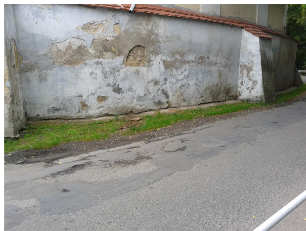
Fot. 10. Widoczny mur okalający kościół z ubytkami tynku. W dolnej części muru widoczne podłużne pęknięcia - odkłucie od fundamentu.. Za murem ściana podłużna kaplicy zmarłych.
