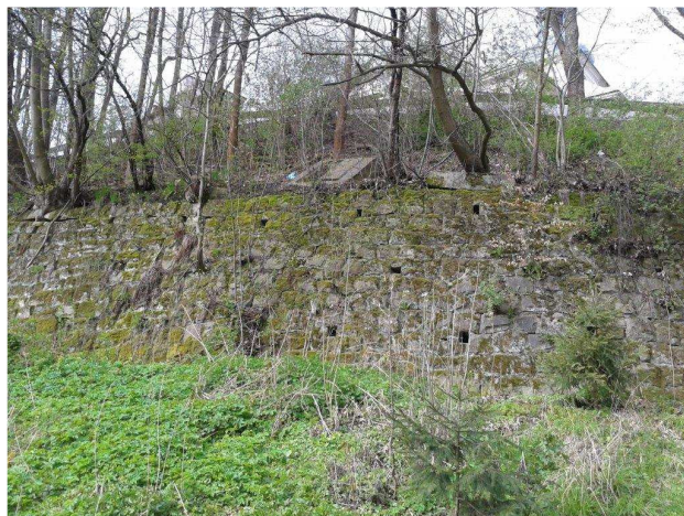
Fot. 7. Widok muru oporowego. Na koronie muru widoczny element betonowy o kształcie ramy z otworem prostokątnym.
