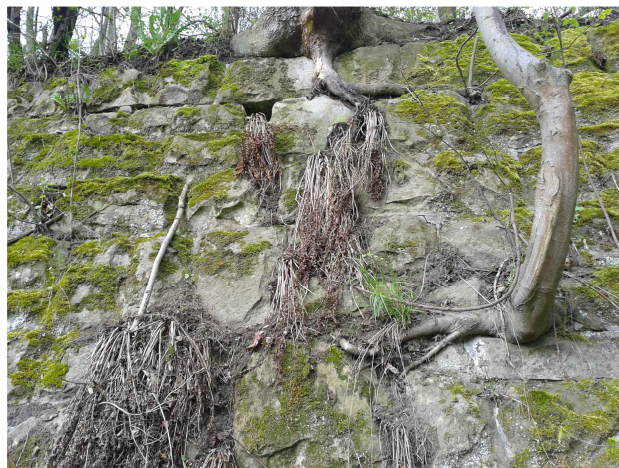
Fot. 8. Widoczne korzenie drzew penetrujące mur oporowy, również w miejscach okienek drenażowych.
